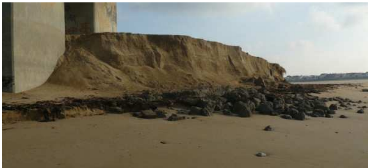
22-11-2010 : Falaise de sable à gauche de la première pile du pont. Fragile, en érosion continue, que va t-il se passer à la prochaine tempête ?
