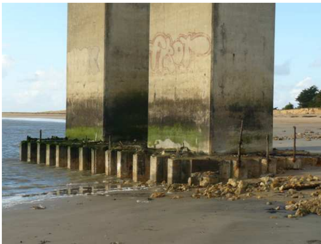
17-11-2010 : Déchaussage de la deuxième pile du pont Disparition d'une hauteur de sable de trois mètres (3) ! Par rapport à la photo précédente.
