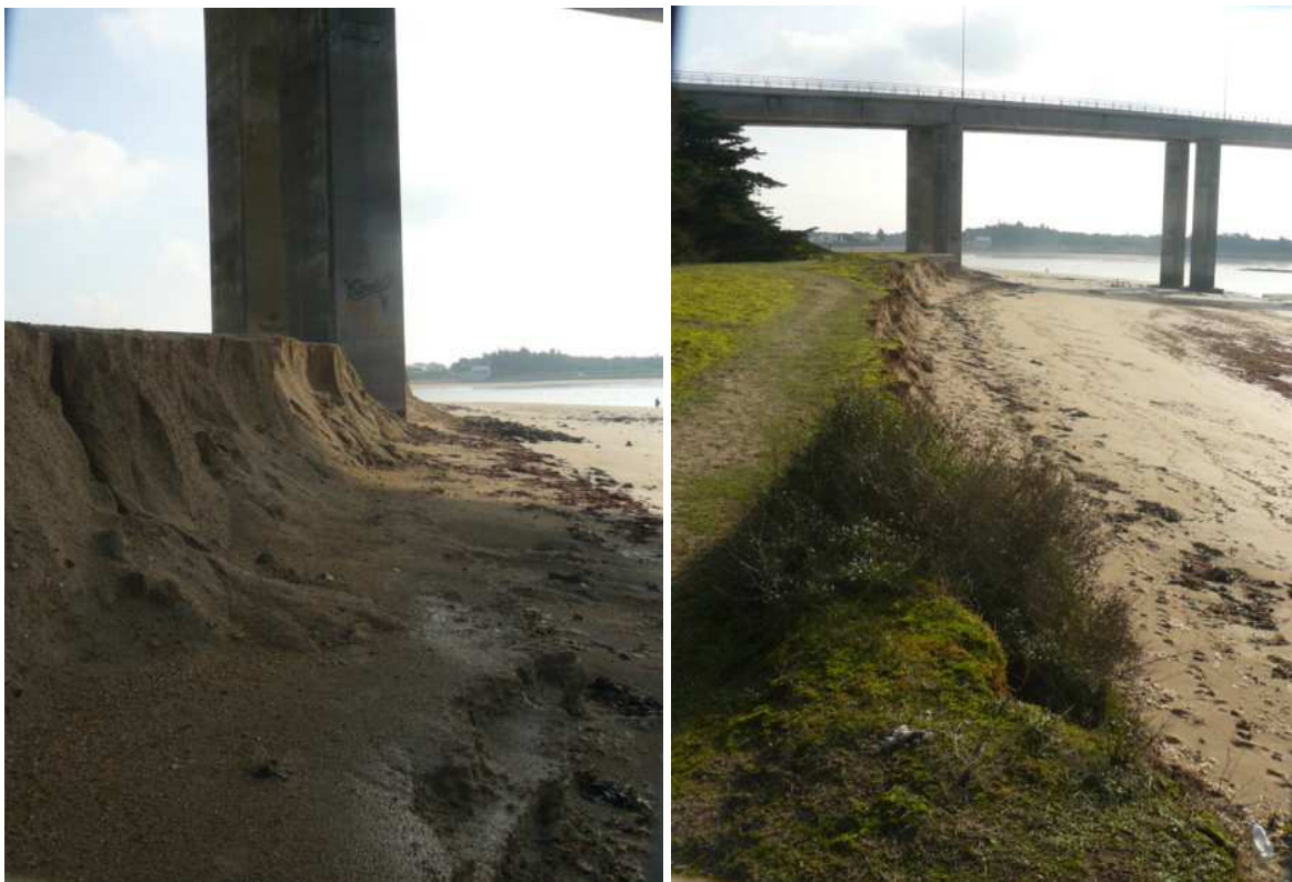
22-11-2010 : A gauche, la falaise mentionnée image précédente. A droite, l'érosion a atteint le sentier piétonnier. La végétation ne maintient plus la falaise trop verticale.
