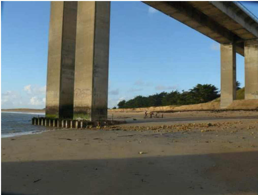
17-11-2010 : Erosion permanente de la falaise de sable sous la première pile Apparition de débris de ferraille sous le pont.
