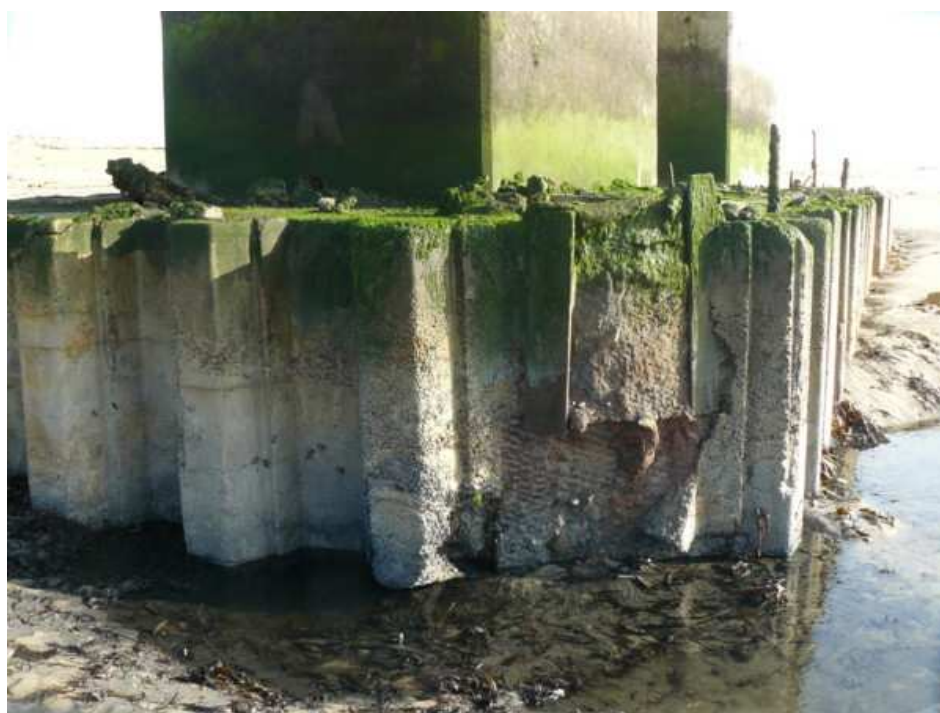
22-11-2010 : le caisson à la base de la deuxième pile du pont est attaqué. On peut constater une érosion rapide tout autour et quelques infiltrations.
