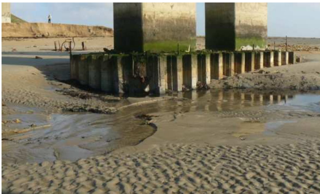
22-11-2010 : Déchaussage accéléré du caisson de soutènement de la deuxième pile du pont.
